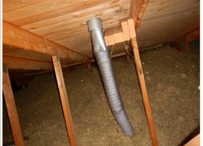
Oisolerad och bristfälligt utförande av ventilationskanal.
