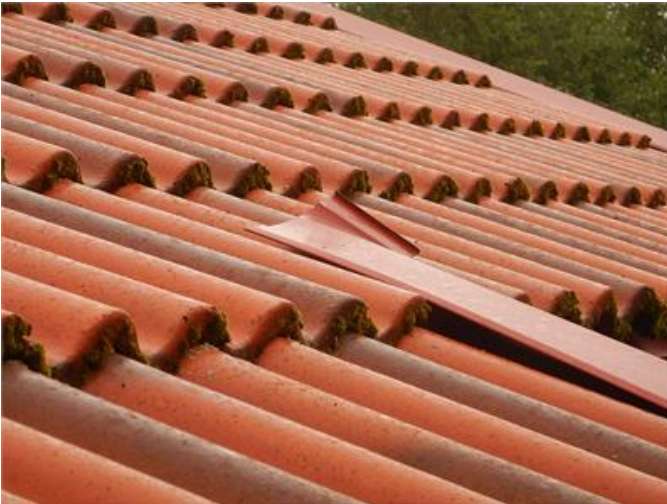
Skevt plåtbeslag ovanför burspråk.
