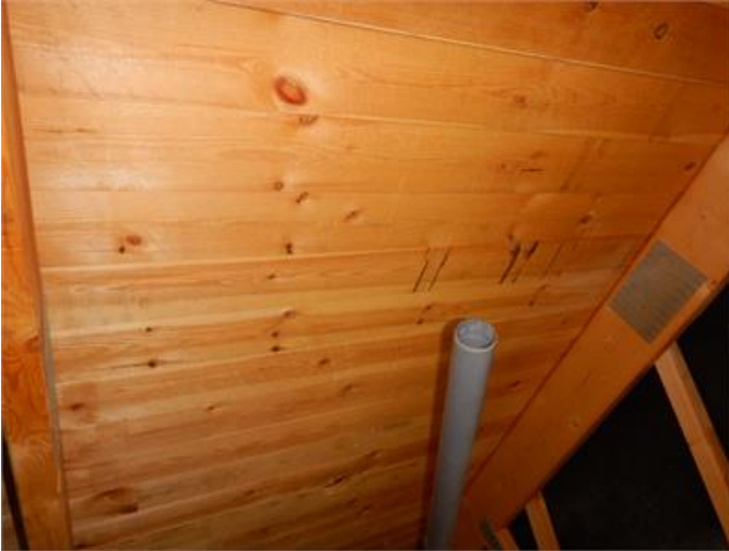
Avloppsluftning mynnar fritt på vinden.
