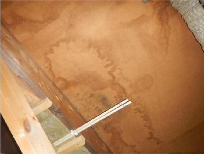
Fuktpåverkan på underlagstak av masonit vind.
