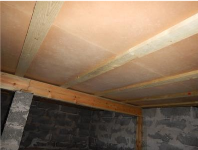
Mikrobiell påväxt på blindbotten krypgrund.
