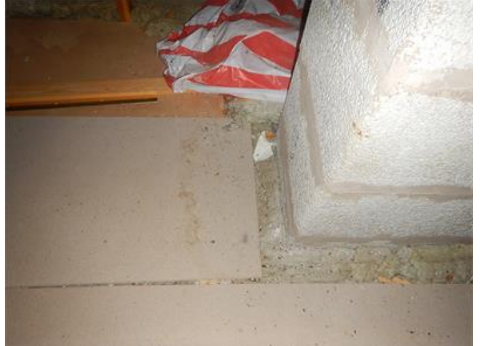
Fuktpåverkan vid murstock på spånskivegolv vind.
