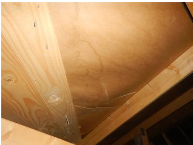
Fuktfläckar på underlagstak vind.
