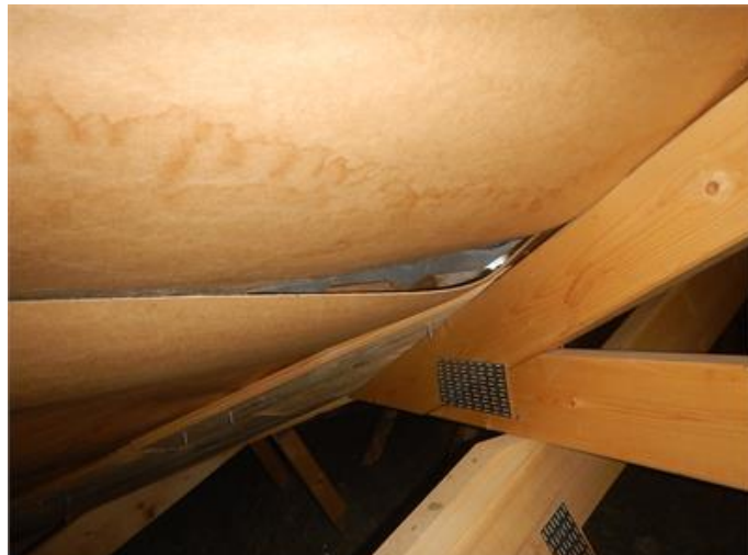
Otätheter i underlagstak vind.
